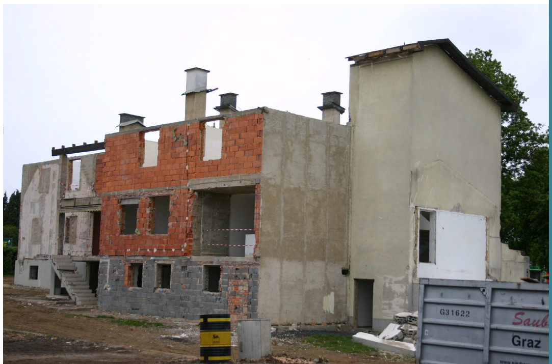
Ein Rückbauobjekt im Freigabezustand: Das Dach ist bereits entfernt, Fenster und Türen sind ausgebaut.
