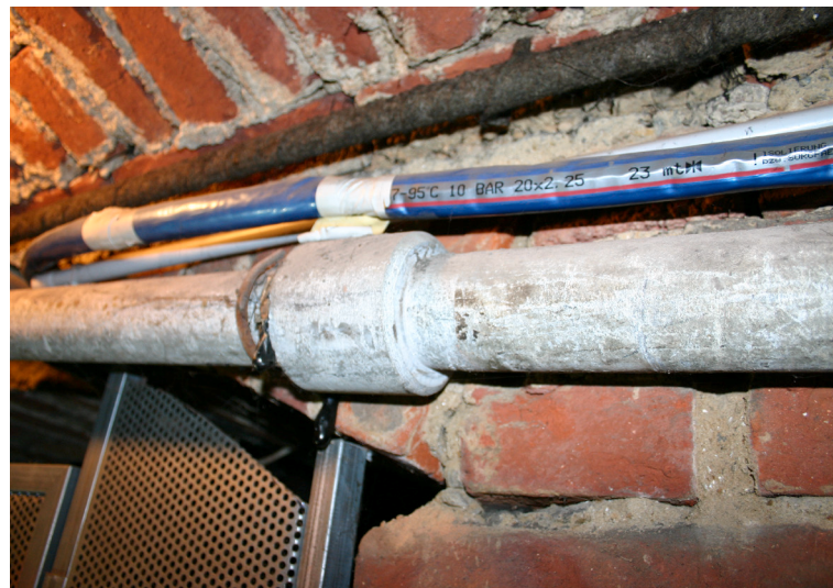
Eine mit Asbest (Schadstoff) ummantelte Rohrleitung
