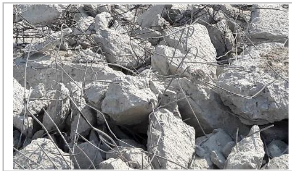
Ansammlung großer Betonbrocken aus denen Baustahlstangen herausragen
