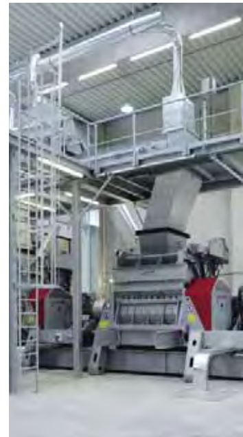
Ersatzbrennstoff-Produktionsanlage ThermoTeam in Retznei.
