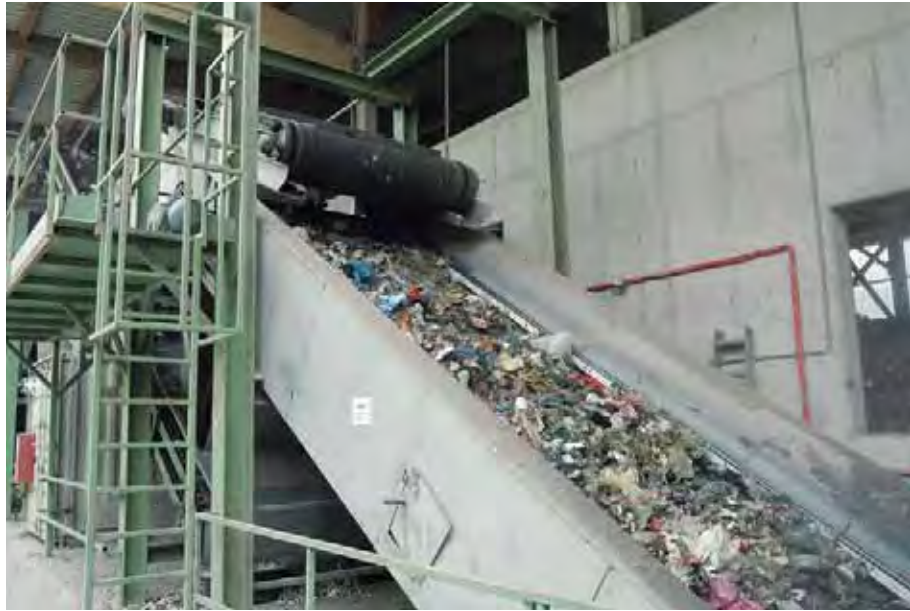
Aufbereitungsanlage am Standort St. Michael.
