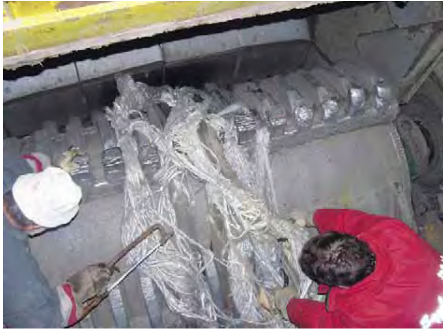
Betriebsstörung der Mühle durch Gurten, Schläuche, Kabel, Teppichreste – Müllanlage Allerheiligen (Foto: AWW Mürzverband).
