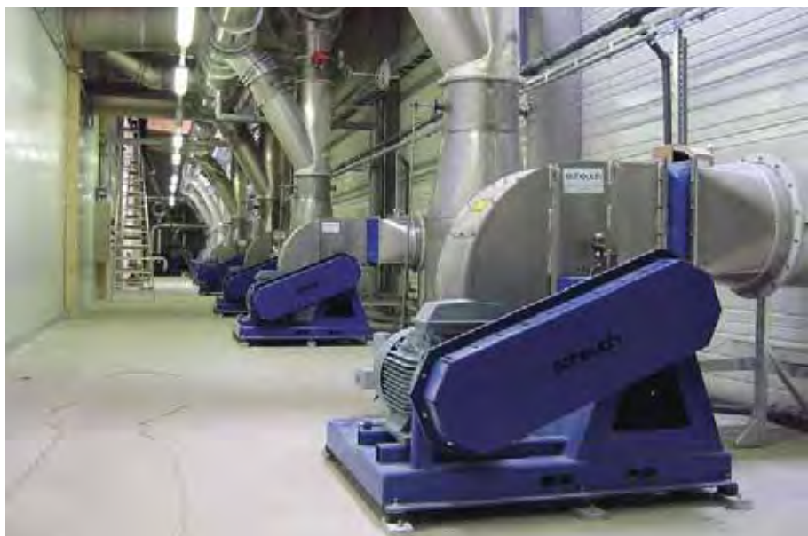
Die Belüftung der Mecha- nisch-biologischen Anlage der A.S.A. in Halbenrain.
