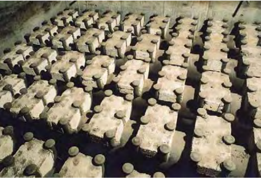
Der Boden des Wirbelschichtofens der thermischen Reststoffverwertung in Niklasdorf.
