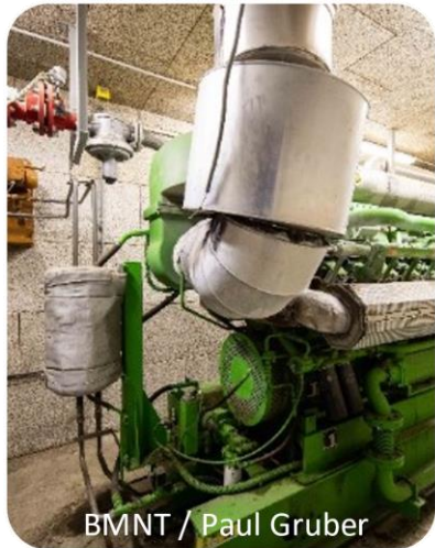
Nah- und Fernwärme
